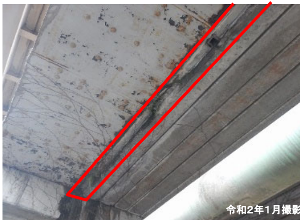
縦目地部の遊離石灰(漏水)
