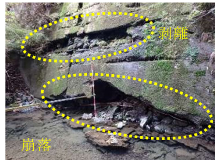
堰堤損傷状況
