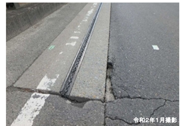
縦目地部の損傷
