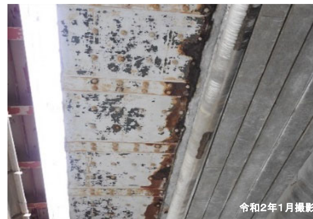
補強鋼板の腐食
