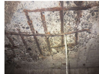
緊急度 I 箇所 (鉄筋露出) の調査結果
