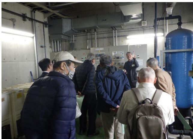
海水淡水化装置の機器説明(支援施設棟)
