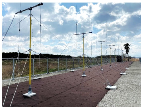
観測局のレーダアンテナ（堺局）
