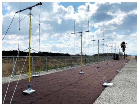
観測局のレーダアンテナ（堺局）
