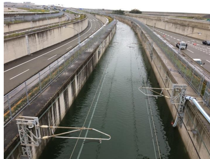
▲鉄道敷掘割浸水状況（9/8撮影）
