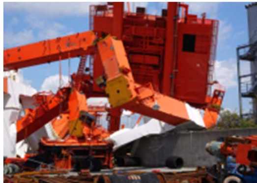
⑨クレーン倒壊（防潮堤損壊）
