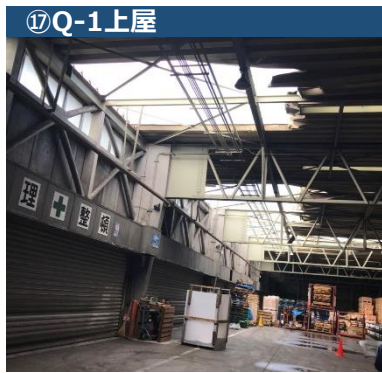
（上屋屋根破損）
