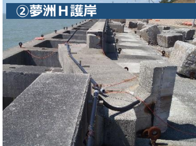
（護岸上部ブロック破損）
