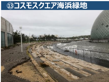
（ブロック舗装・階段部破損）
