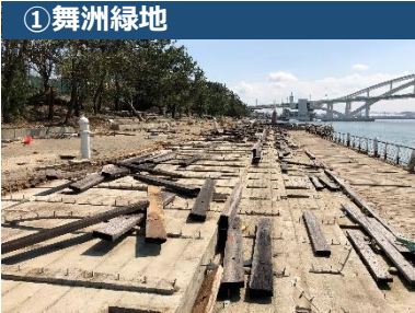
（ボートワーク破損）
