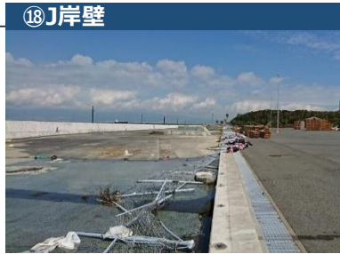
（ソーラフェンス破損）
