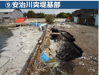
（岸壁舗装陥没）
