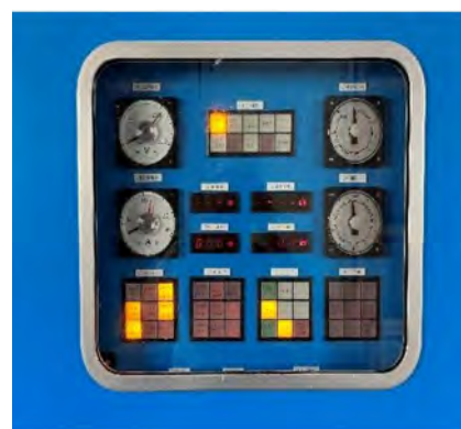
クレストゲート機側操作盤改良
