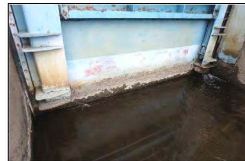
損傷箇所(ゲートの腐食)
