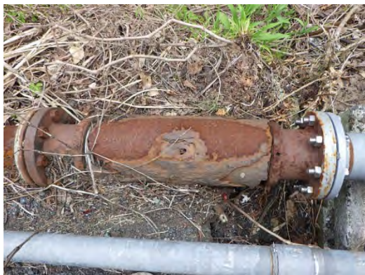
配管腐食状況
