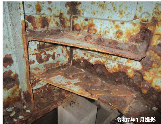
縦桁(ボルト)の損傷
