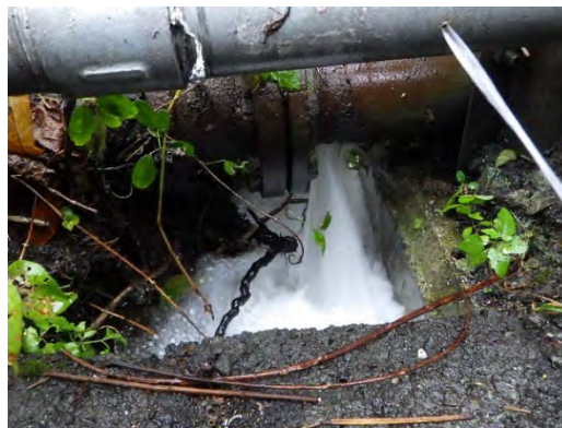
送水管の漏水の状況
