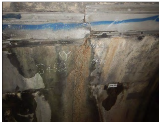
アーチ部の漏水
