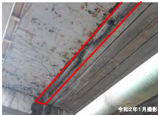
縦目地部の遊離石灰(漏水)
