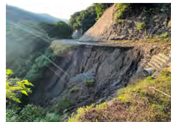
写真③ 国道365号 とちのきとうげ 栃ノ木峠道路区間被災状況（R4.8大雨）
