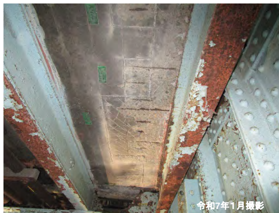
主桁・床版の腐食
