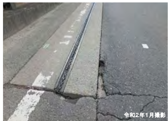
縦目地部の損傷
