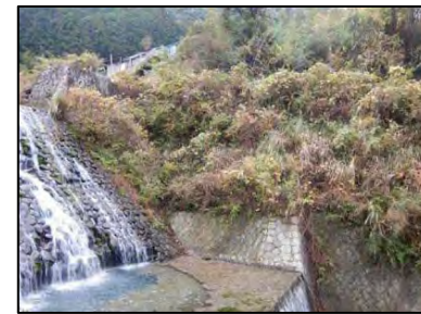
水叩損傷状況
