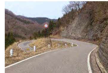
写真② 線形不良箇所写真（H25.4）
