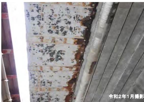
補強鋼板の腐食
