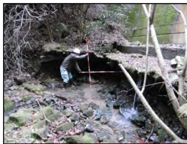
水叩損傷状況
