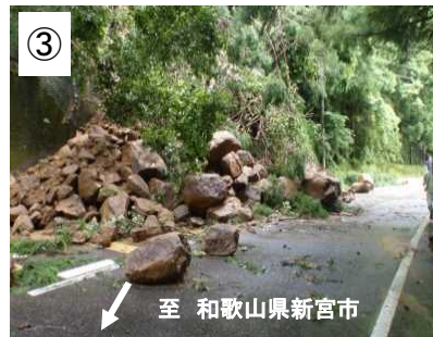
法面崩落状況(H29)
