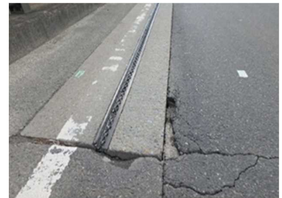
縦目地部の損傷
