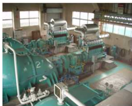
新川排水機場
