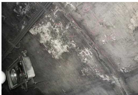
既設剥落防止の劣化
