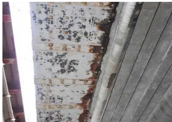
補強鋼板の腐食
