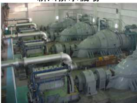
東川排水機場
