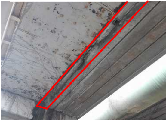
縦目地部の遊離石灰(漏水)
