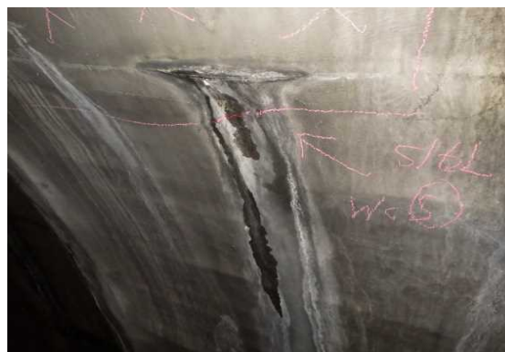
覆工からの漏水
