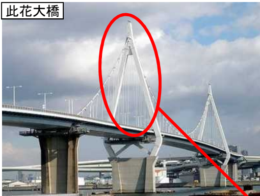
塗装劣化状況 (主塔部)
