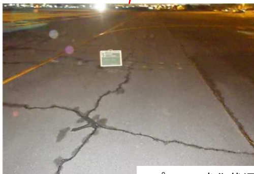
エプロンの劣化状況
