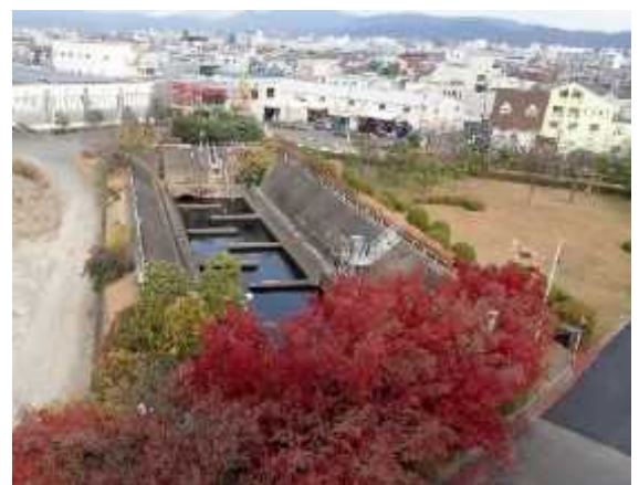
消毒施設(塩素混和池)
