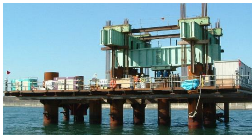
図-1. 国内最大規模の静的載荷試験 (東京ゲートブリッジ: 鋼管杭径1,500mm)
