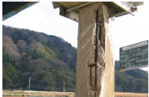
コンクリートが剥離し鉄筋が露出
