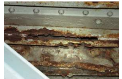
トラスの腐食
