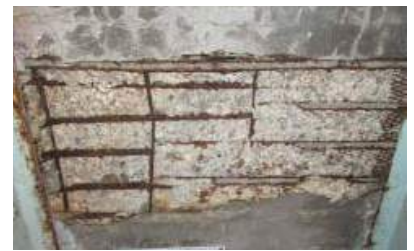
床版の剥離・鉄筋露出
