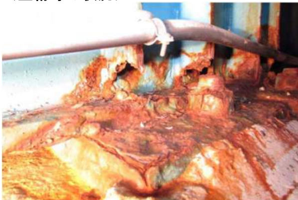
桁端部からの漏水による主桁等の腐食
