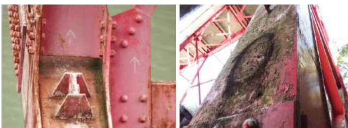
鋼部材の防食機能の劣化状況
