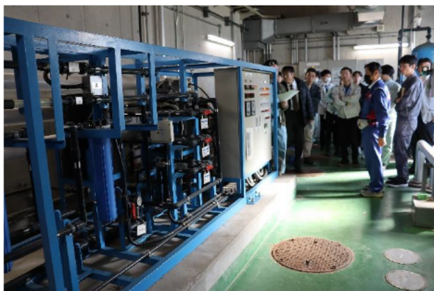
海水淡水化装置の説明(支援施設棟)
