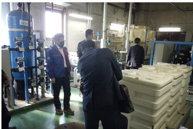
海水淡水化装置の説明 (支援施設棟)
