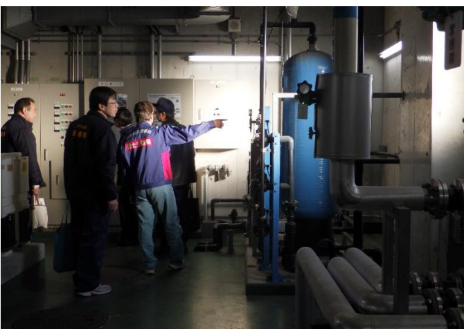
海水淡水化装置の説明 (支援施設棟)
