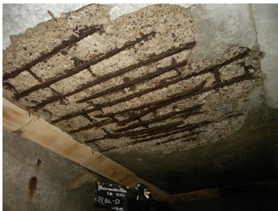
栈橋下面部の鉄筋露出状況 図-5 鉄筋腐食調査状況
