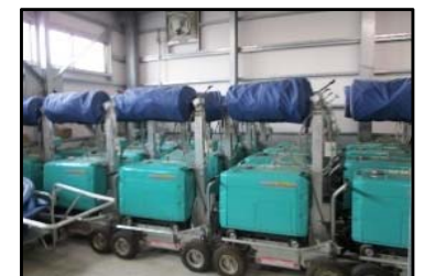
投光器付発電発電機
