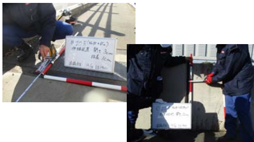
道路班による被害調査
