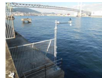
左図: 設置された電波式潮位計
