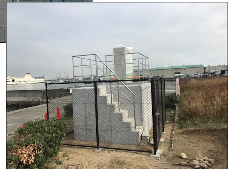
【非常用電源の整備後】
