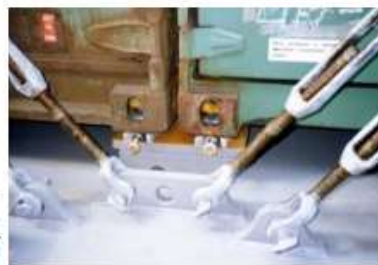
コンテナの流出防止対策 (固縛設備)
