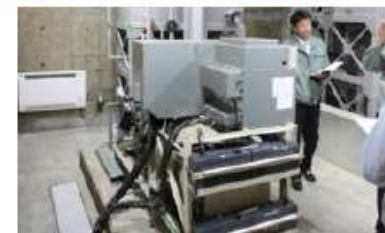
非常用電源の設置
