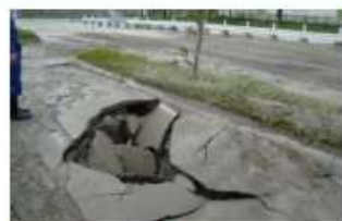
地震により液状化する臨港道路
