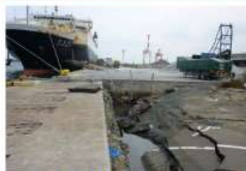
非耐震強化岸壁背後の陥没
