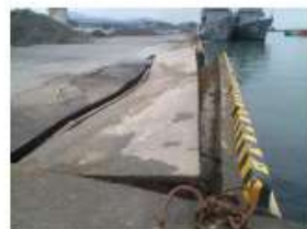
地震により被災する岸壁
