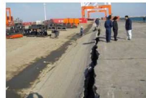
非耐震強化岸壁背後の陥没
