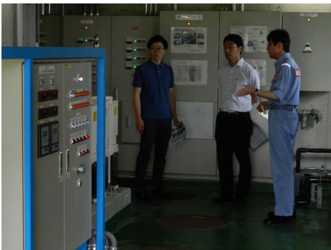
支援施設棟での海水淡水化装置見学
